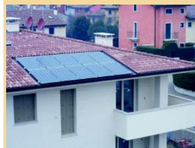
Pannelli fotovoltaici , dettaglio della posa sul fronte sud della copertura di un fabbricato.
