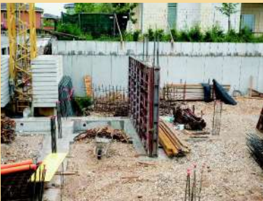
Murature di elevazione , fase di armatura per il successivo getto in opera.
