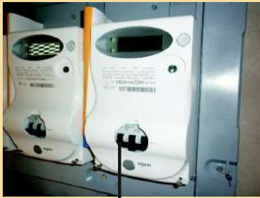
Interruttore generale on/off
