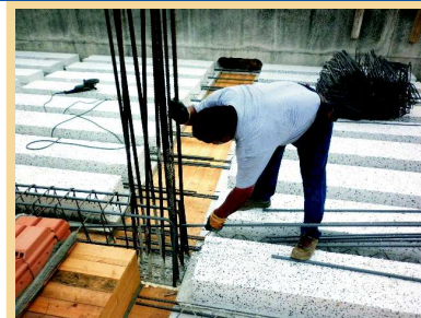
Lastre "Predalles" fase di armatura del solaio al piano terra, questi tipi di solai a copertura dei piani interrati, possono presentare nei primi due anni di esercizio delle piccole infiltrazioni di acqua accumulata durante le fasi di cantiere all'interno delle lastre e comunque destinata ad evaporare o scendere nei periodi di bassa pressione atmosferica, pertanto è importante non forare per qualsiasi motivo i soffitti dei garage.
