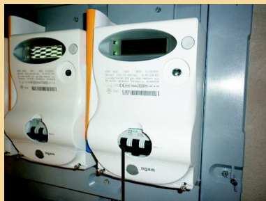
Interruttore generale on/off
